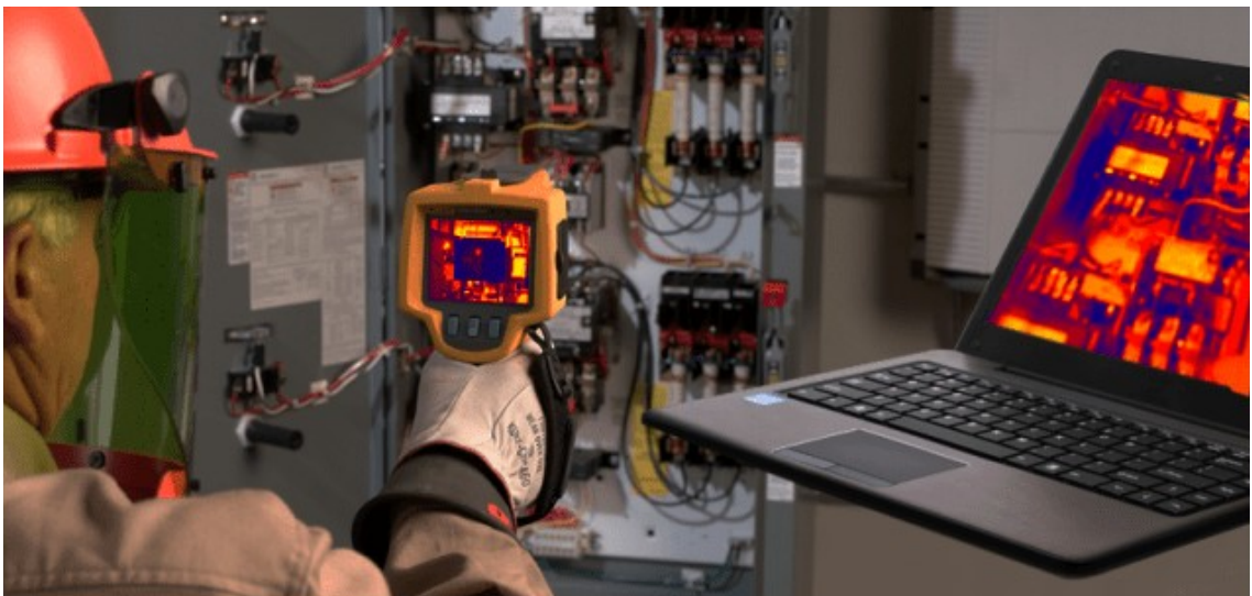
Рисунок 20. Пример проведения тепловизионного контроля электрошкафа
