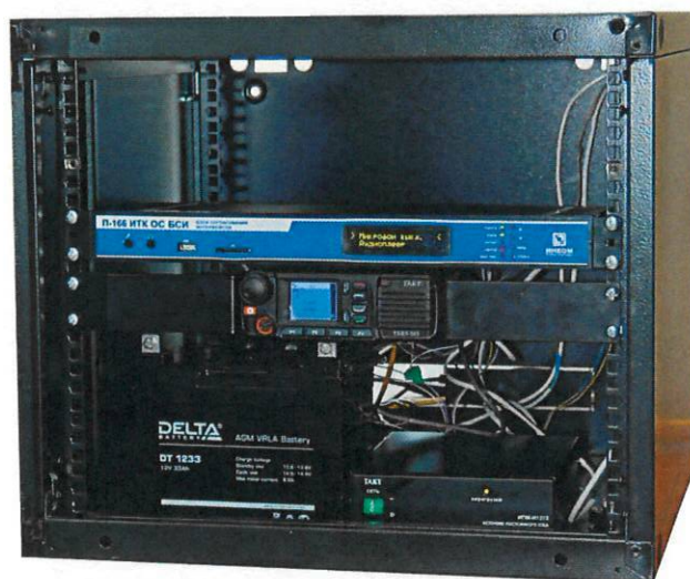
Рисунок А.4.14 – Базовая управляющая радиостанция управления ИТК ОС БУР
