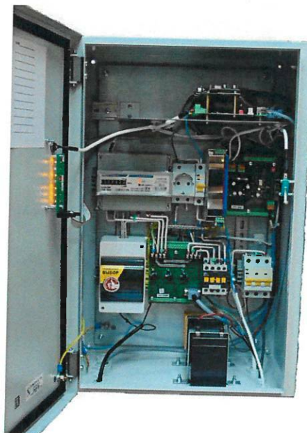
Рисунок А.4.8 – Устройство управления электросиренами ИТК ОС УЭС
