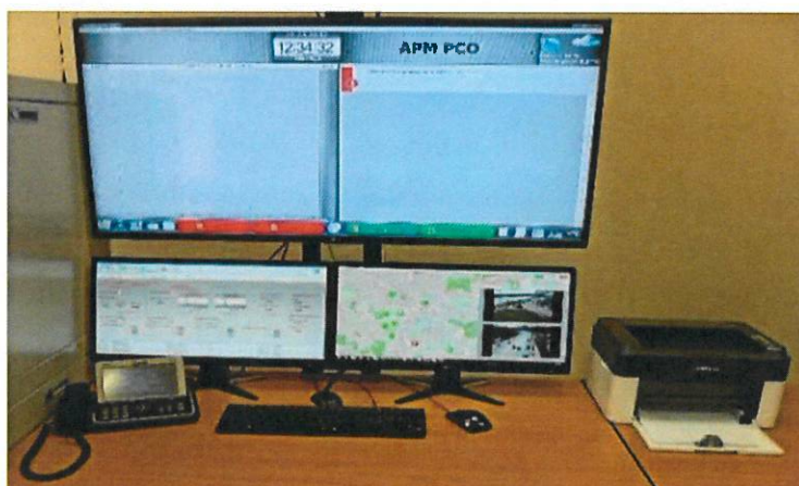
Рисунок А.7.1 – АРМ региональной системы оповещения
